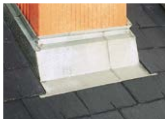
Abergements de cheminées
