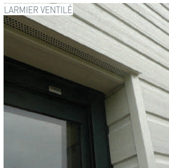
Rejet d'eau au-dessus des menuiseries et ventilation.
